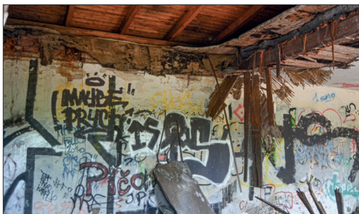
V důsledku vydatných dešťů se propadla střecha nádražní budovy na vlakové zastávce Petrov u Prahy. Správa železniční dopravní cesty rozhodla o její demolici a stavbě nové zastávky.
